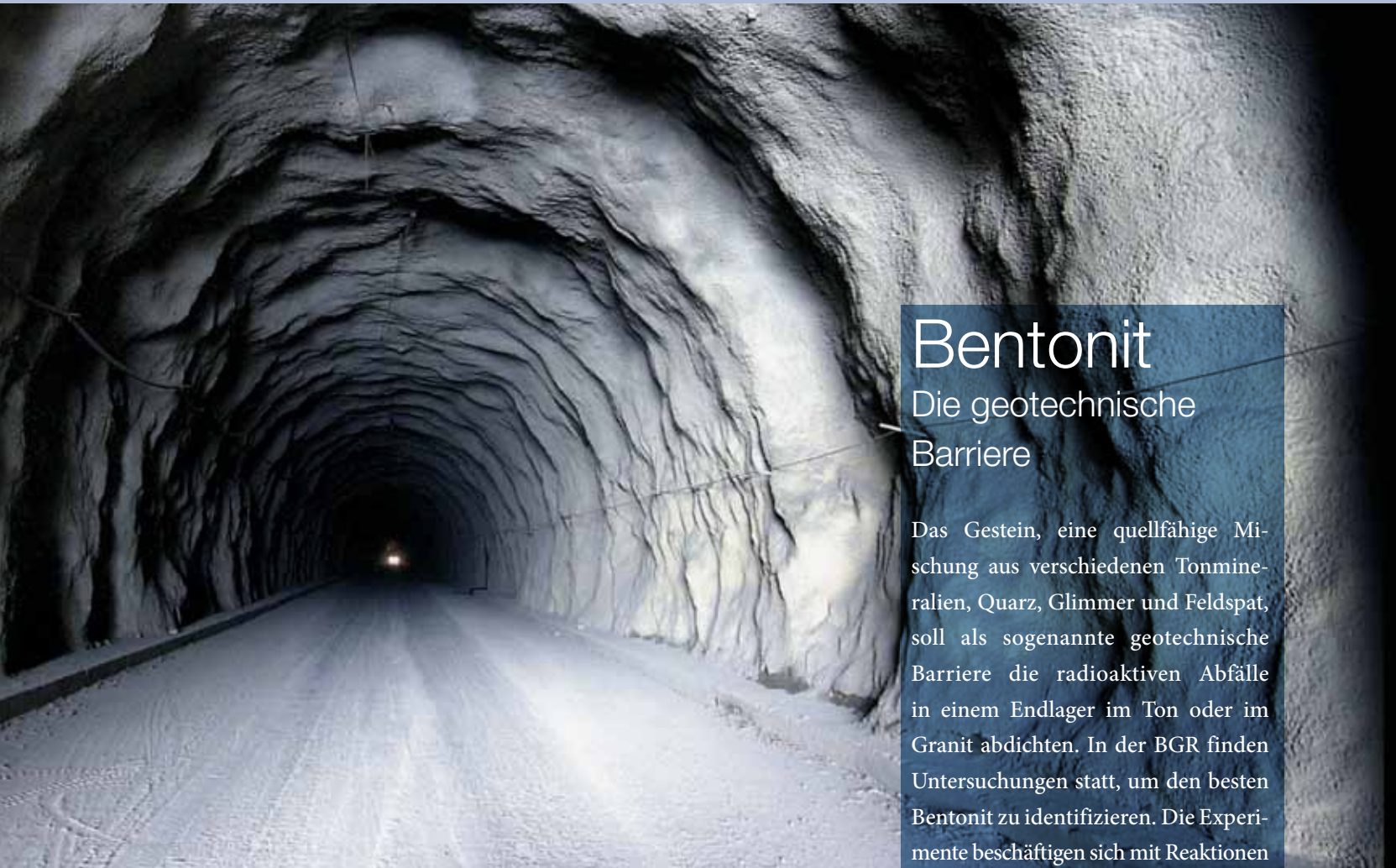
Sondierstollen im internationalen Felslabor Mont Terri (Schweiz).
