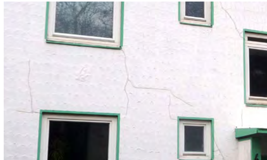
Wohngebiet in Bremerhaven: Durch unzureichende Gründung der Gebäude in den Marschsedimenten kommt es zu Rissbildungen und Schiefstellungen.
