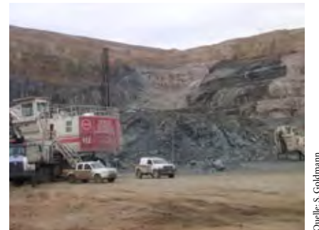
Tagebau am Platreef in Südafrika. Die verwitterten Gesteine nahe der Oberfläche sind deutlich an ihrer braunen Färbung zu erkennen.
