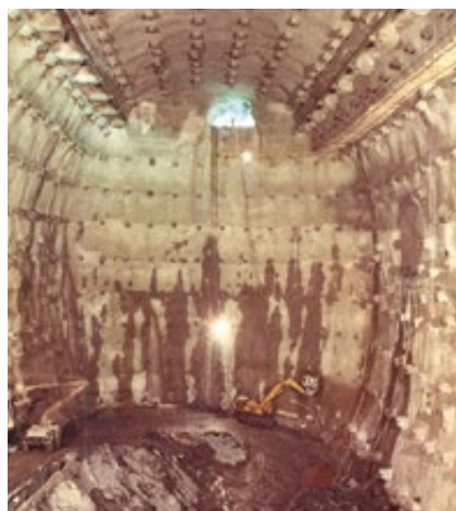
▲ Maschinenkaverne während der Auffahrung mit kombiniertem Ausbau aus bewehrtem Spritzbeton und Systemankerung.
