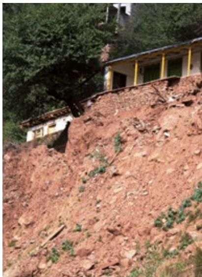
▲ Ein durch eine Hangrutschung zerstörtes Haus entlang der Straße Islamabad – Muzaffarabad in Pakistan.
