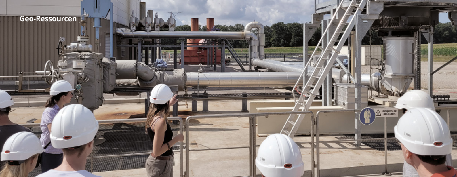
Die Außenanlagen des Geothermiekraftwerks in Rittershoffen im Oberrheingraben in Frankreich während einer Exkursion des Verbundprojekts im Juli 2022.
