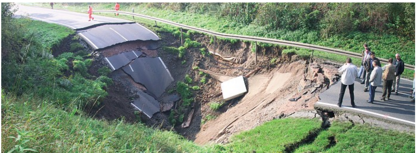
Frischer Erdfall auf der Bundesstraße B 180 bei Neckendorf.
