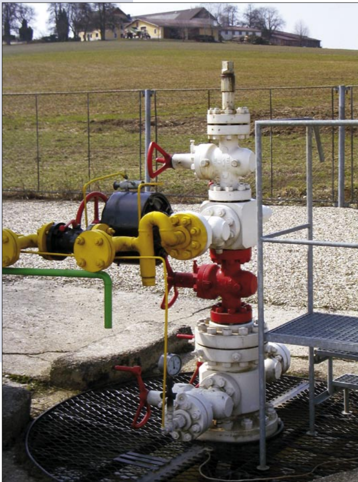
Bohrlochkopf in einem Gasfeld in der österreichischen Molasse. Im Bohrloch verbaute Rohre und Zemente werden auf ihre Langzeitsicherheit für eine Endnutzung als CO 2 -Speicher getestet.
