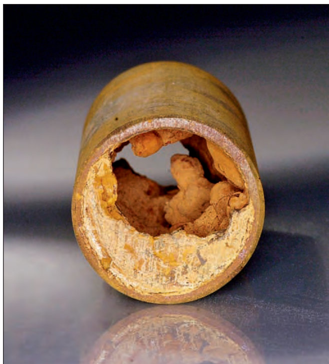
Rohr mit Ablagerungen.
