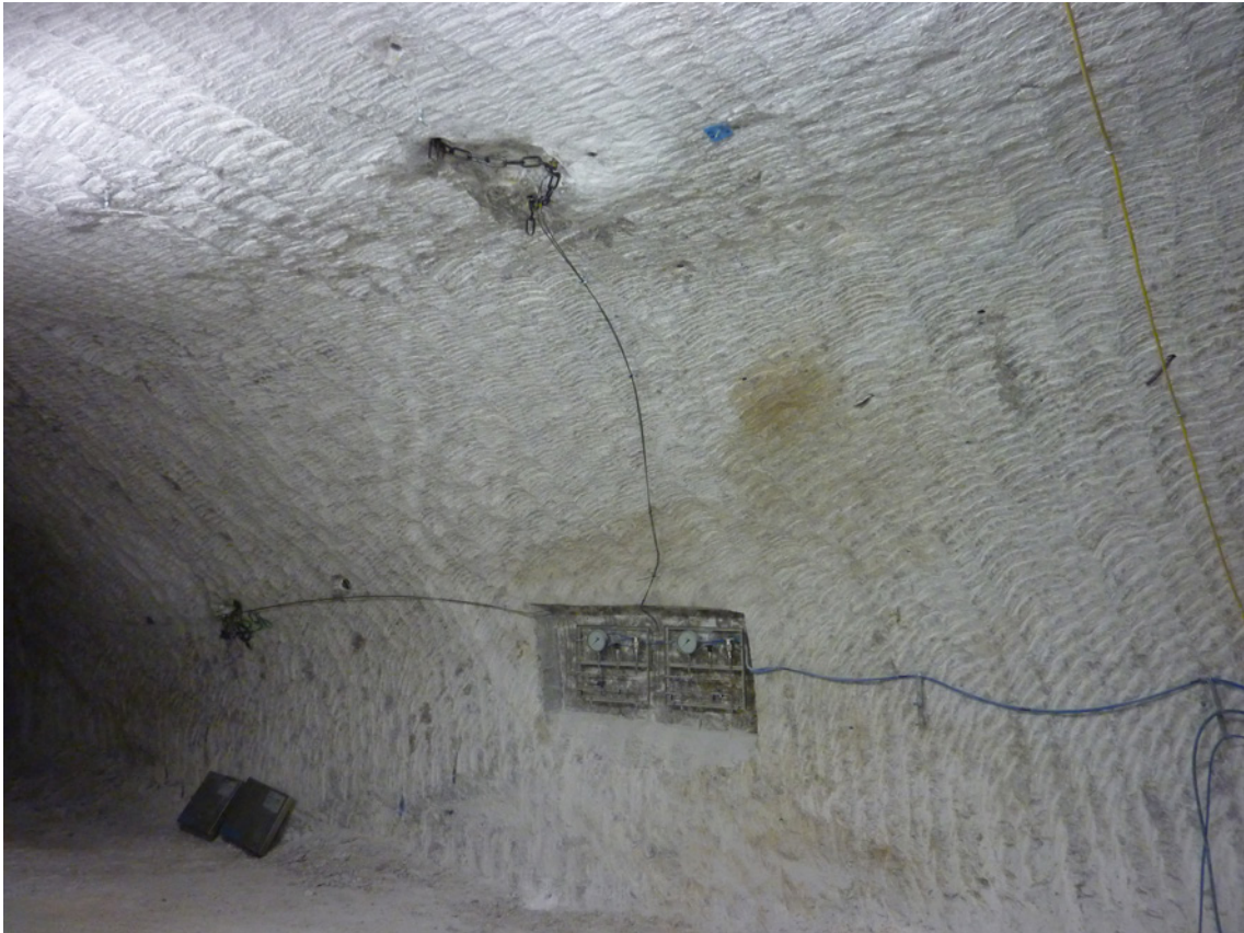
Abb. 10: Installiertes Messequipment bei den KW-Packerbohrungen RB695 und RB696
