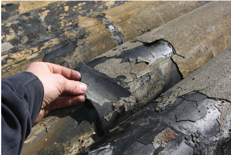
Abbildung 2.23: Kompakte flächige Ablagerungen am Pumpenstrang.
