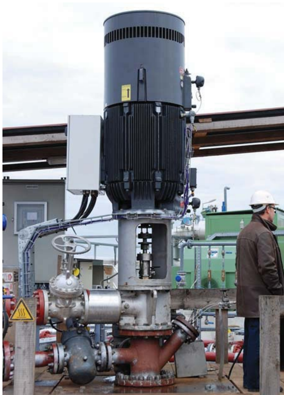
Abbildung 3.27: Pumpe Soultz-sous-Forêts: Oberirdischer Motor der Gestängepumpe in Soultz-sous-Forêts.
