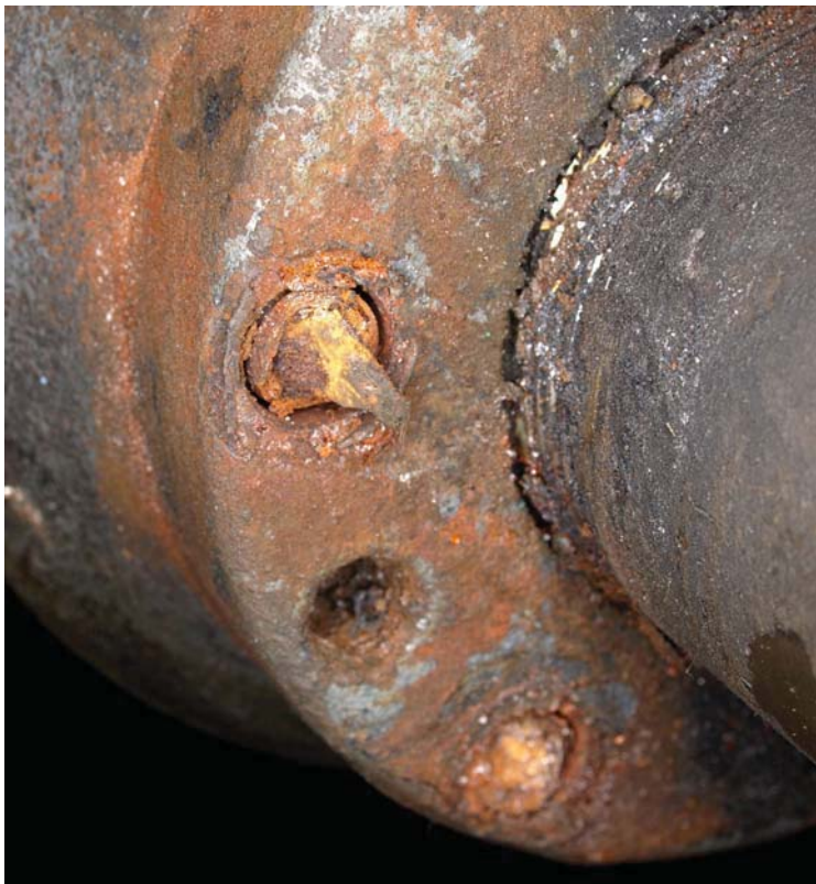
Abbildung 3.22: Pumpe Reichstag: Korrodierte Schraubverbindungen Motorgehäuse.
