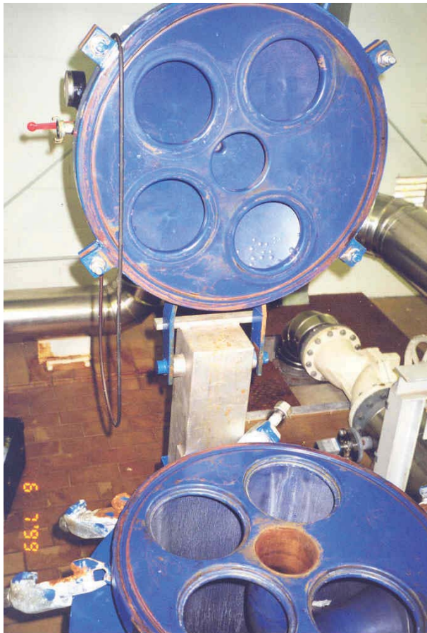
Abbildung 3.62: Filterhaus I, Grobfilter, deutliche Blasenbildung im Bereich des Deckels
