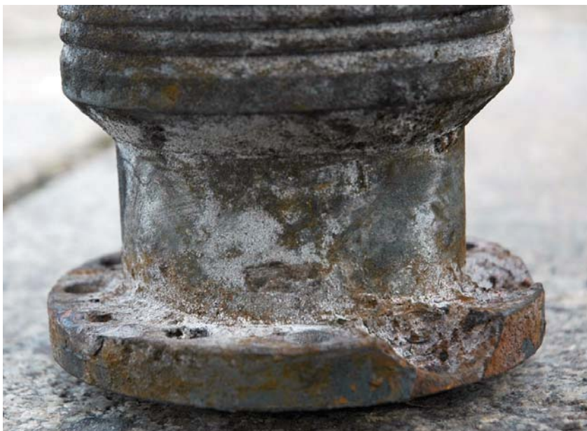
Abbildung 3.20: Pumpe Reichstag: Korrosion Gehäuseteil. Foto: BGR.
