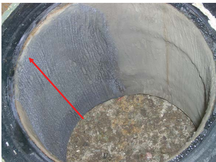
Abbildung 3.59: Blick in das Formstück Nr. 4, beginnende Ablagerungen von silbriggrauem Scale, roter Pfeil zeigt die Fließrichtung an. Oben beginnende hauchdünne graufarbige Ablagerungen rechts oben in Fließrichtung schauend
