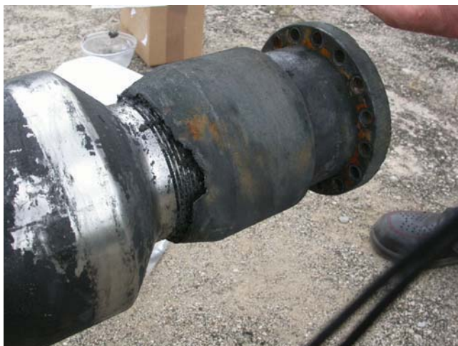
Abbildung 2.19: Übergangrohr zwischen Pumpe und Rückschlagklappe. Zum Teil hat sich das Stahlgefüge völlig aufgelöst.
