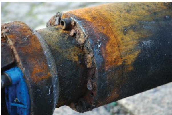
Abbildung 2.22: Korrodierte Schrauben am Pumpenmotor.
