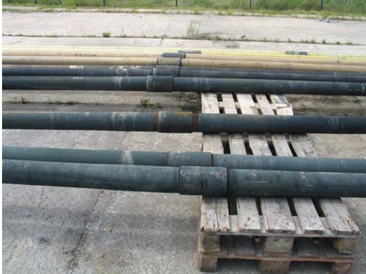
Abbildung 2.20: Auf der Steigleitung haben sich grüne Ablagerungen gebildet. Das Foto entstand kurz nach dem Ausbau der Pumpe.
