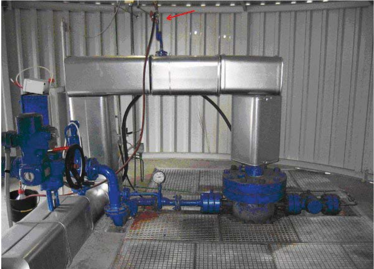
Abbildung 3.44: Entnahmestelle für Thermalwasser- und Gasproben am Leitungskopf nach der Förderbohrung (rechts unten)
