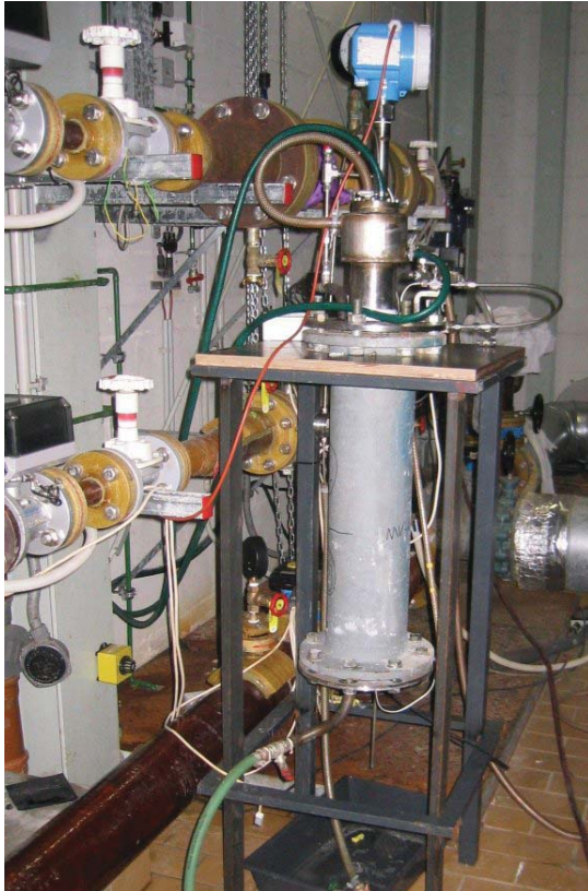
Abbildung 3.42: Gasseparator mit Radar-Sonde; links im Hintergrund der Bypass.
