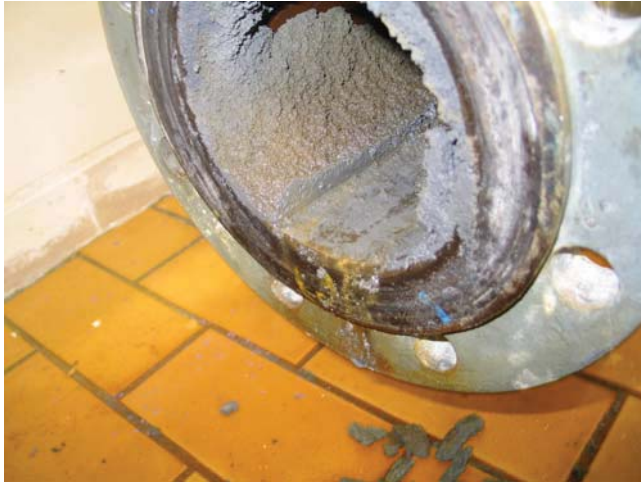
Abbildung 3.15: Rohrflansch mit Ablagerungen der Geothermieranlage von Neustadt-Glewe.
