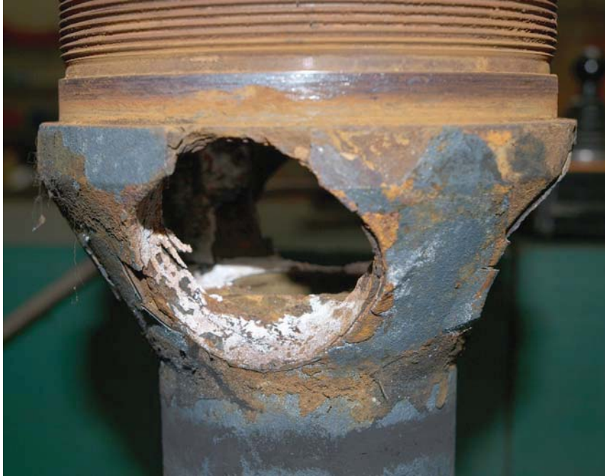
Abbildung 3.21: Pumpe Reichstag: Pumpeneinlass.
