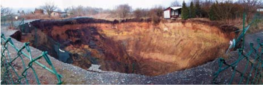
Abb. 3: Nachbruch Erdfall Gartenanlage im März 2003 (Foto: U. HEROLD).
