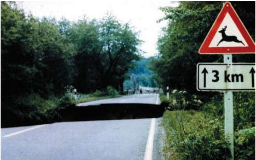
Abb. 1: Erdfall auf der ehem. F 180 am 13. 06. 1987 (Foto: J. HECKNER)
