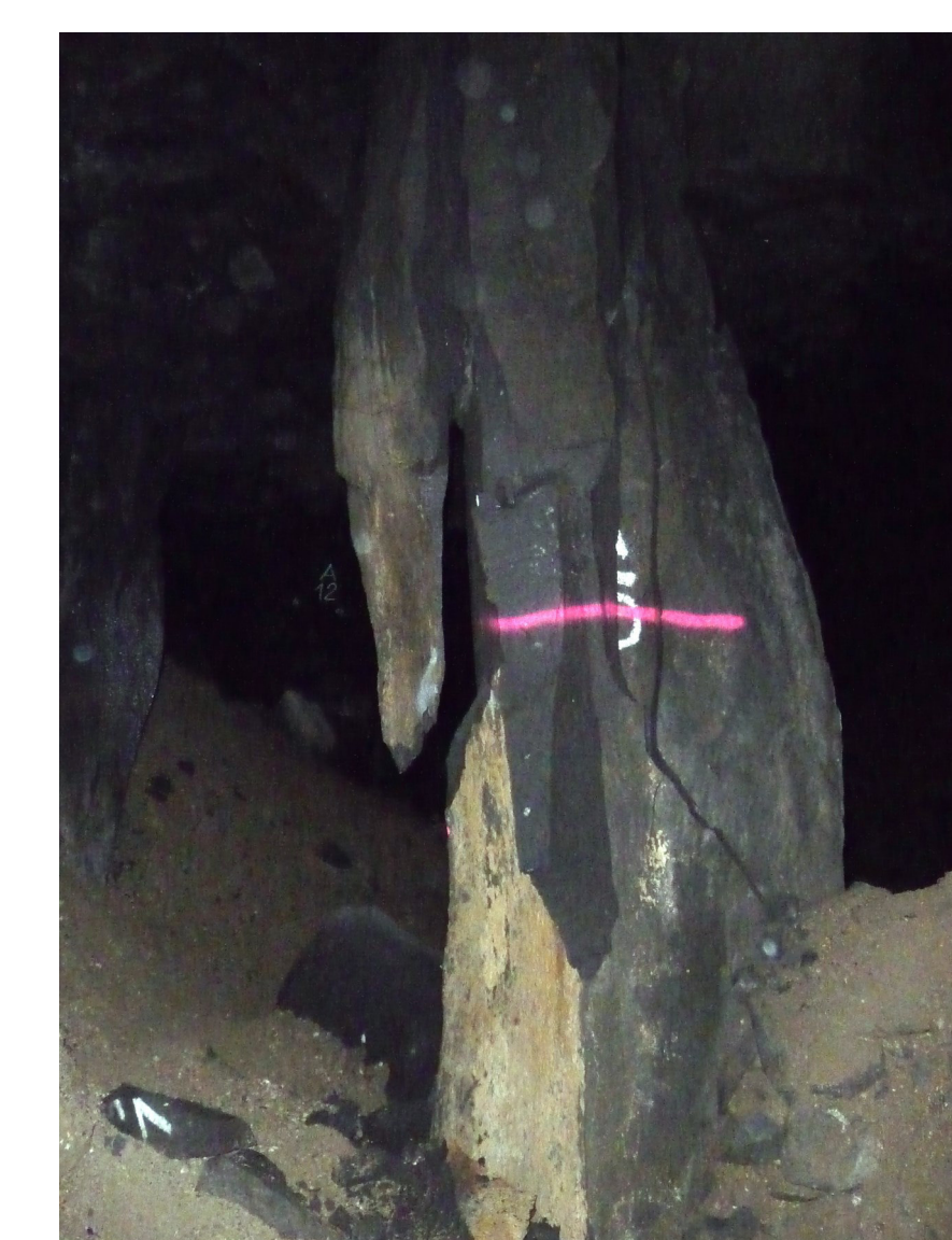
Abb. 7: Stark beanspruchter Basalt-Stützpfeiler.
