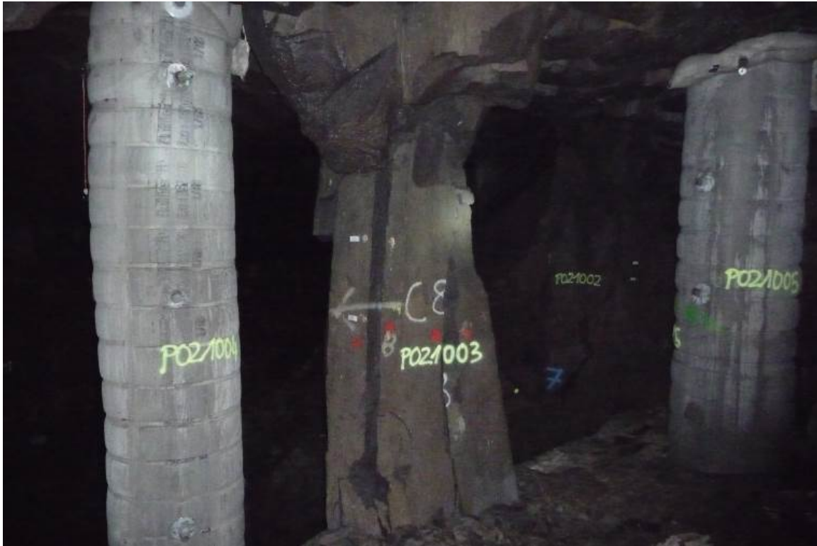
Abbildung 32: Ein schwer beschädigte Basaltpfeiler mit Messmarkierungen wird durch zwei Bullflexpfeiler unterstützt (Foto: C. Wolf, Februar 2014).
