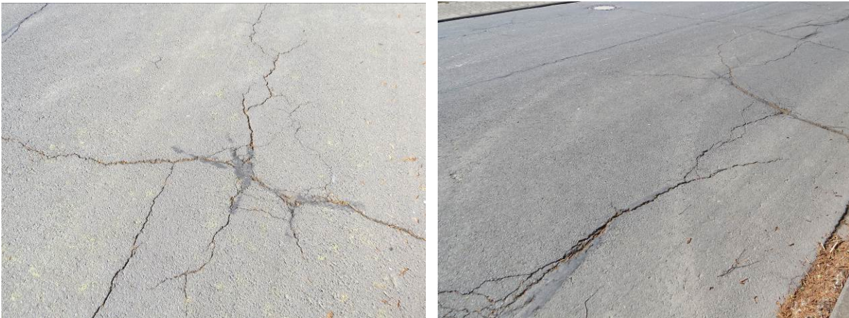
Abbildung 87: Straßenschäden am Rande des Mayener Grubenfeldes weisen auf mögliche Bewegungen des Untergrundes hin und machen eine weitere Erkundung bzw. Monitoring des Gebietes erforderlich.
