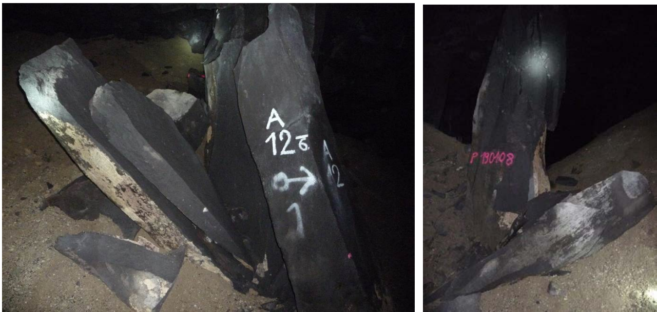
Abbildung 70: Zerbrochene und stark beschädigte Basaltpfiler unter Tage unter der Petershütte (Foto: C. Wolf, Februar 2014).
