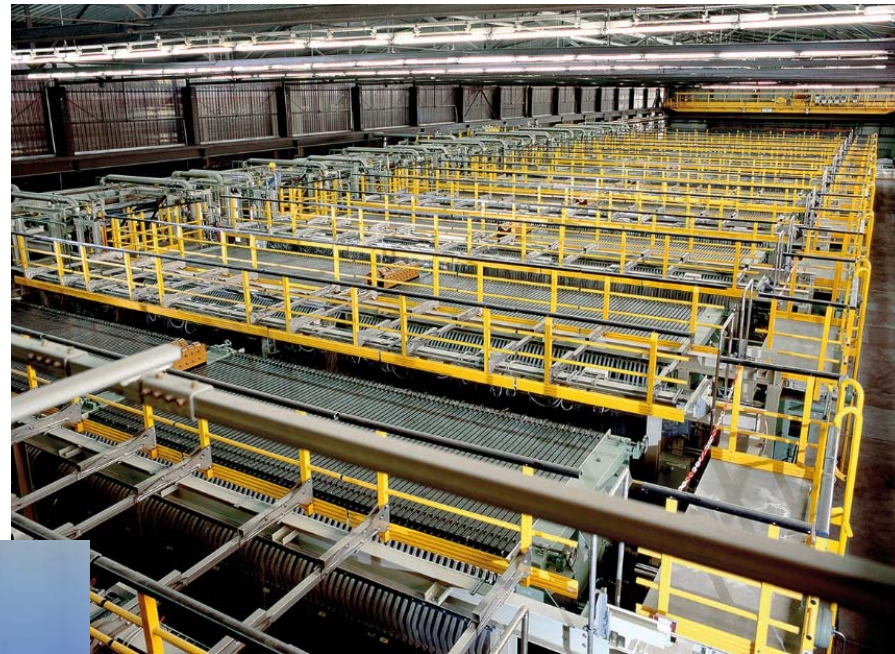
Chloralkali-Elektrolyse der BASF, Foto BASF SE
