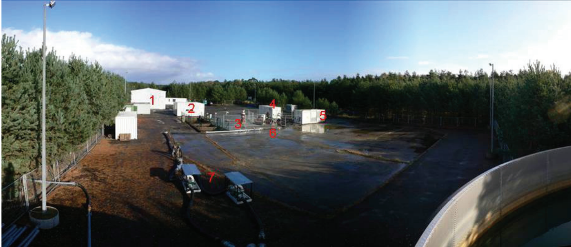
Abb. 1.8: Bohrplatz der Bohrung Horstberg Z 1: (1) Lager- und Montagehalle; (2) Messcontainer; (3) Pumpenkammer; (4 u. 5) Hochdruckpumpen; (6) Bohrlochkopf; (7) Niederdruckleitungen mit Ladepumpen
