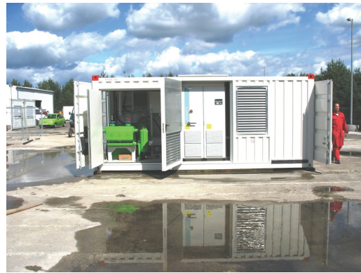
Abb. 1.5b: Hochdruckpumpe: Steuerungs- und Pumpenseite mit Frequenzumrichter und Triplexpumpe
