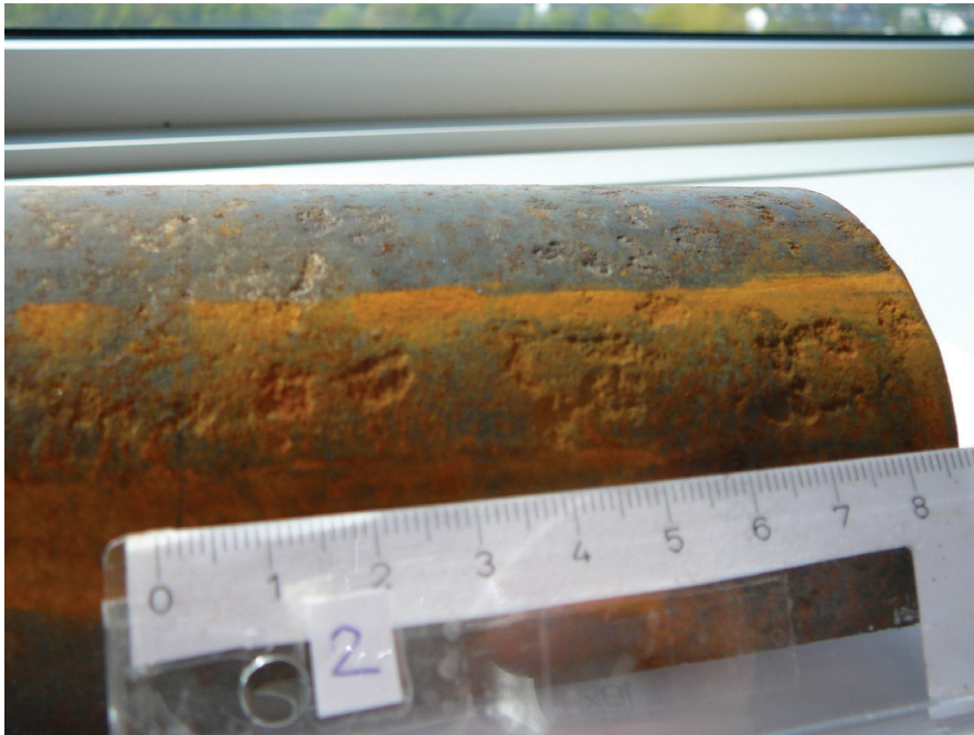
Abb. 4.2.1: Korrosionsschäden an der Außenwand von Rohrstück Nr. 2
